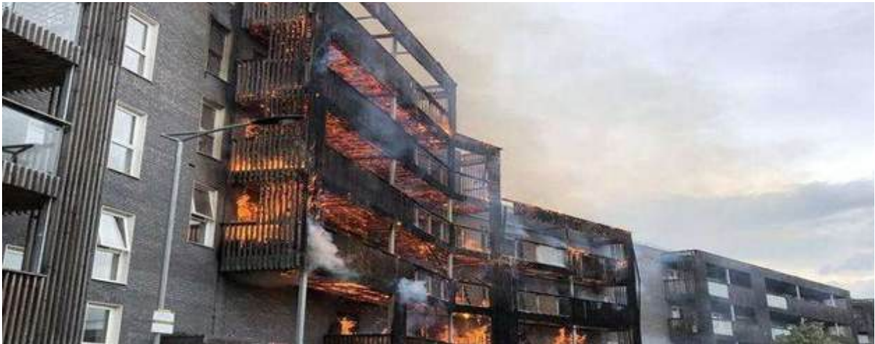
DIFFUSIONE DELL'INCENDIO TRAMITE BALCONI ESTERNI
